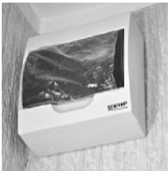
Квартирный щиток «ЩК»
