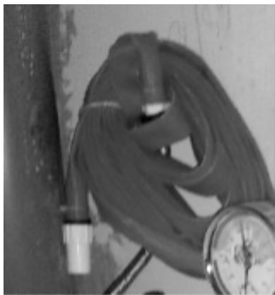
Устройство внутриквартирного пожаротушения КПК
